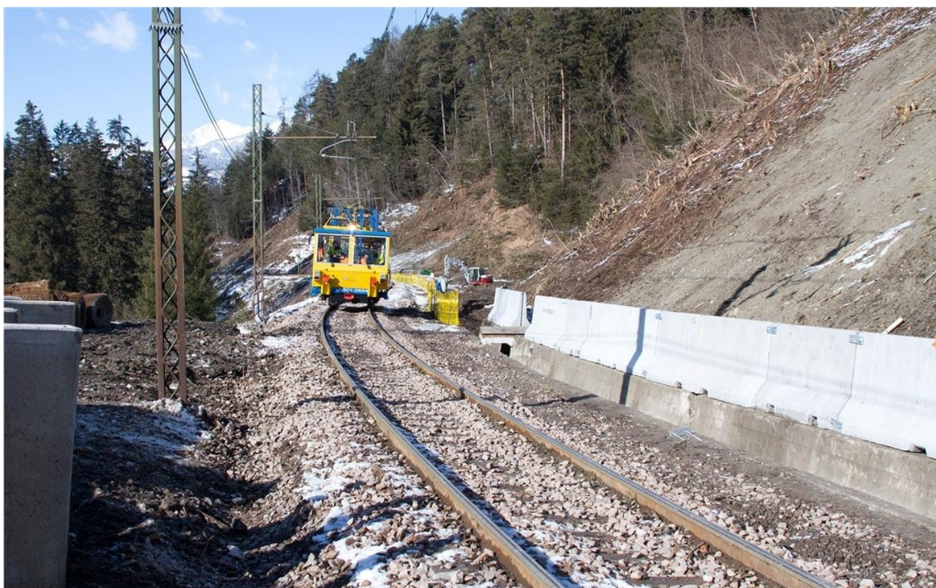
1 1 Dopo la frana, gli interventi di messa in sicurezza della ferrovia della Pusteria a Valdaora sono quasi ultimati. Foto ASP/Ingo Dejaco
