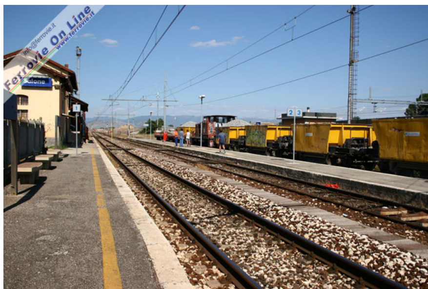
La stazione di Salone durante i lavori per l'attivazione del raddoppio, che lato Sulmona terminerà in questo impianto. Foto David Campione, 3 luglio 2005
