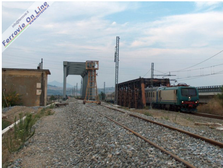
Una E.464, alla trazione del regionale festivo 8497 istituito per i mesi centrali della stagione estiva, transita sul vecchio ponte mentre nel cantiere si provvede alla posa della linea aerea. (Foto Mario De Prisco, 28 agosto 2005)
