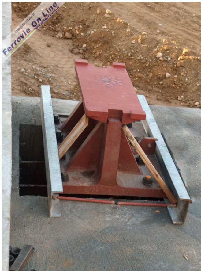
La cerniera sulla spalla sud posizionata ma ancora da cementare. Foto Mario De Prisco, 28 novembre 2004
