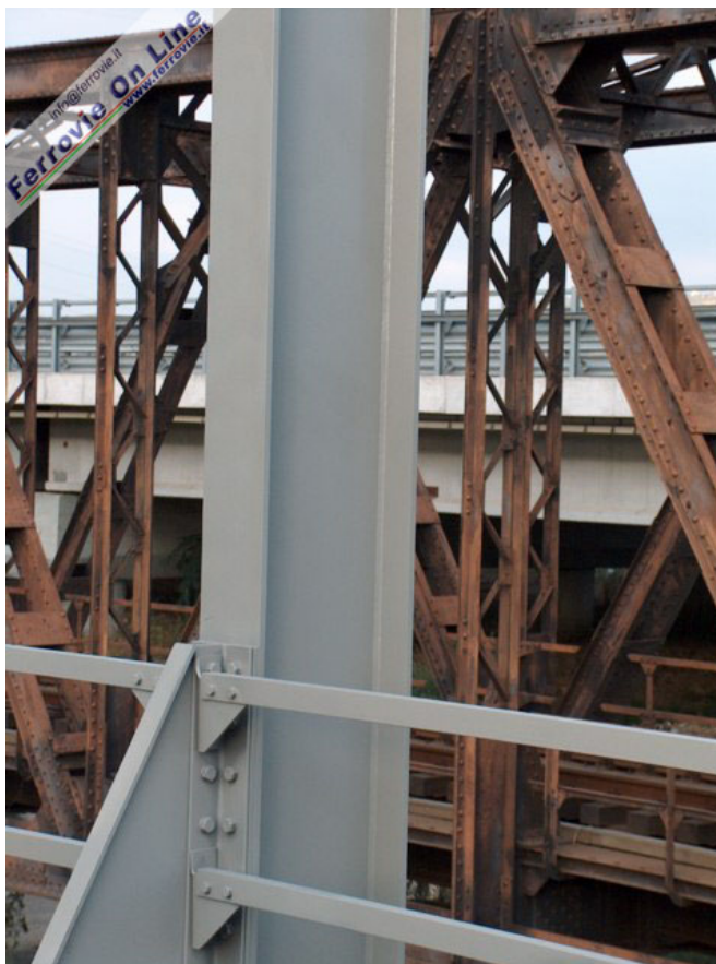
A confronto la lineare eleganza dei profilati adottati per il nuovo ponte e il merletto di chiodature che furono necessarie per l'assemblaggio del vecchio manufatto. Foto Mario De Prisco, 18 settembre 2005
