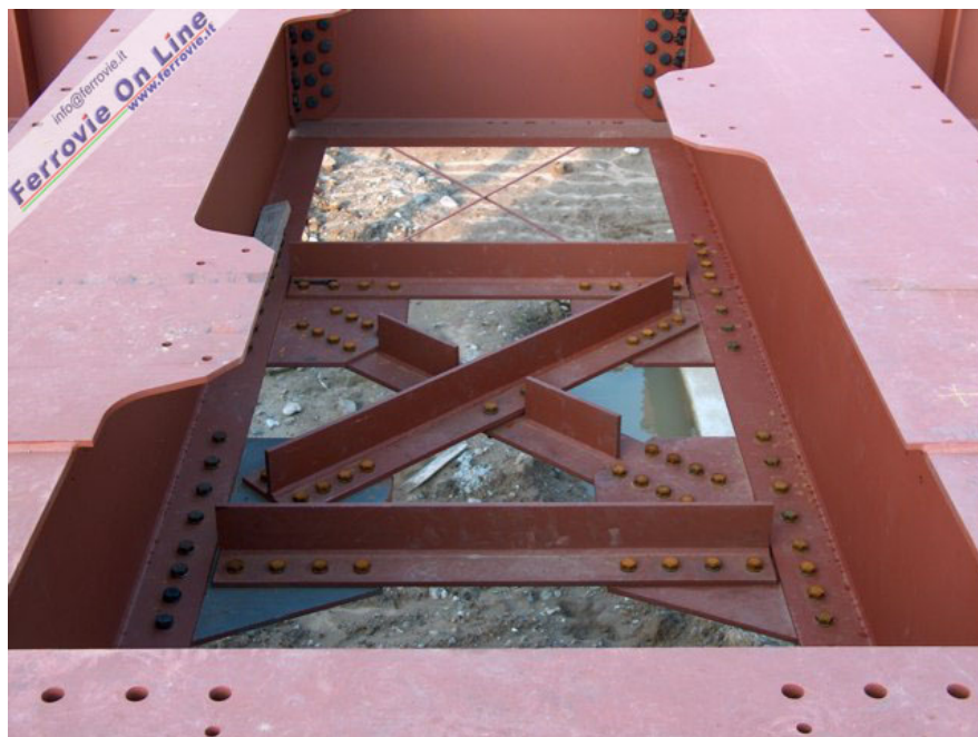
Le crociere inferiori fra i longheroni destinati a sostenere il binario. (Foto Mario De Prisco, 06 febbraio 2005)
