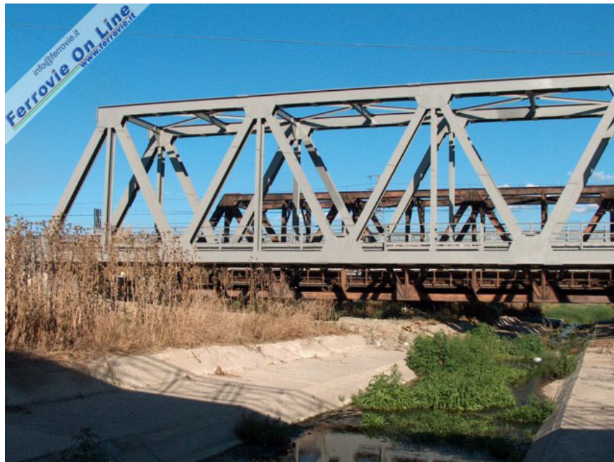
Una vista delle due travate. Il torrente Cocchiato durante il periodo estivo si riduce ad un rigagnolo che non sembra giustificare le importanti opere ferroviarie ed autostradali per scavalcarlo. A rimettere le cose a posto ci pensano i volumi d'acqua che si raccolgono nel periodo invernale e la violenza impressa al torrente dalle pendenze tipiche di questi territori. (Foto Mario De Prisco, 16 agosto 2005)
