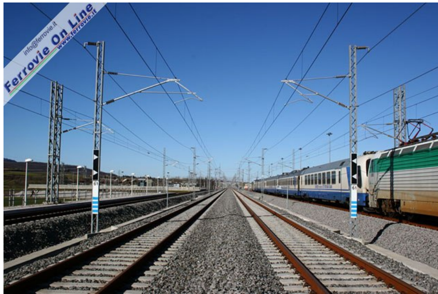
4. Per l'Alta Velocità si è prescelta la palificazione LS già in opera su gran parte della rete FS e sospensioni apposite per l'Alta Velocità. Nell'immagine ripresa nel Posto di Movimento e Comunicazione di Anagni, palo LS con sospensione a sinistra tipo SA0 T e a destra tipo SA0 C. (Foto David Campione, 2 febbraio 2005)
