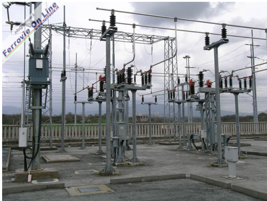
3. La Sottostazione Elettrica di Anagni. (Foto David Campione, 20 marzo 2004)
