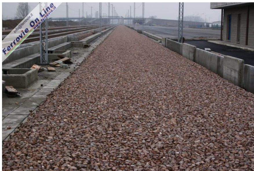
5. Binario di precedenza lato fabbricato di servizio. Qui è stato posato il primo strato di pietrisco, in attesa di poggiare traverse e rotaie. Foto David Campione, 19 febbraio 2006
