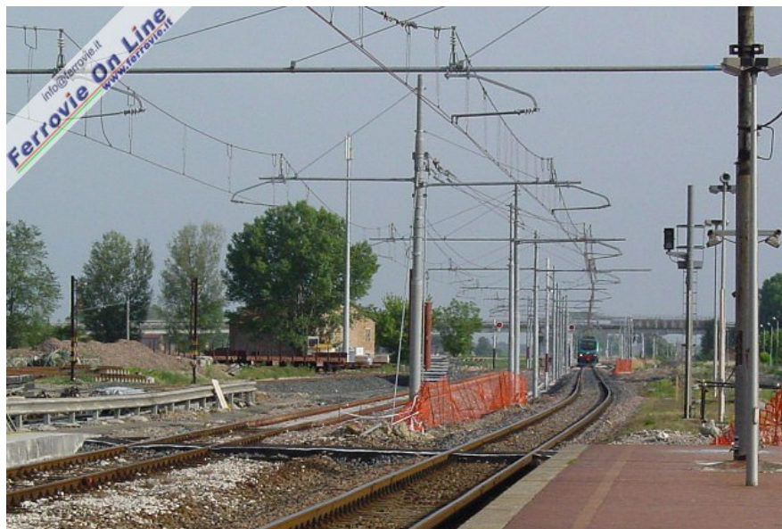
6. L'IR 2266 Bologna C.le - Brennero, qui in arrivo a S. Felice sul Panaro, sta percorrendo la breve variante di tracciato attivata all'inizio di maggio. In fondo a destra è visibile la vecchia sede del binario unico, con il relativo varco creato sotto il nuovo cavalcavia. Attualmente la stazione di S. Felice sul Panaro ha in esercizio soltanto due binari, in quanto il III e il IV sono stati dismessi. (Foto Fabio Veronesi, 17 giugno 2006)
