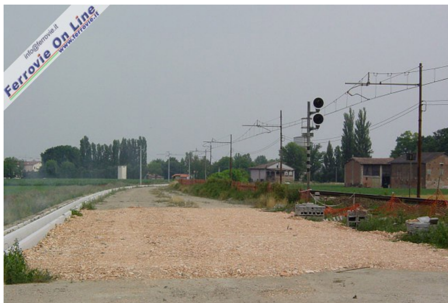
7. Decisamente più arretrati i lavori di raddoppio tra S. Felice sul Panaro e Mirandola. Le opere civili sono appena abbozzate, ma la futura sede ferroviaria risulta già predisposta, ad eccezione dei tratti in corrispondenza dei passaggi a livello. Nell'immagine, la situazione dei lavori in corrispondenza del segnale di avviso di S. Felice sul Panaro. Pressoché inesistenti, invece, i cantieri nel tratto Mirandola - Poggio Rusco. (Foto Fabio Veronesi, 17 giugno 2006)
