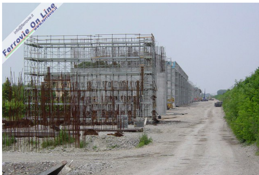
5. Qui invece un'immagine del cantiere sul versante modenese, in corrispondenza del paese di Camposanto. In alcuni punti si notano le travate prefabbricate in cemento armato già installate. L'apertura della nuova tratta a doppio binario è prevista per giugno/luglio 2007 e dovrebbe comprendere la nuova fermata in viadotto di Camposanto. (Foto Fabio Veronesi, 17 giugno 2006)
