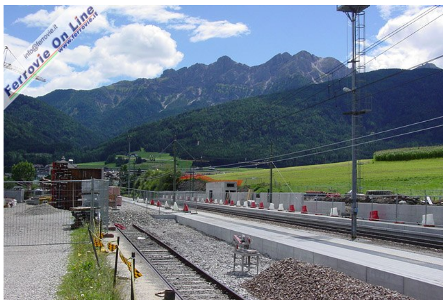
I nuovi marciapiedi della stazione di Valdaora, decentrati lato San Candido rispetto a quelli ora in uso. Rimangono comunque ubicati all'interno dell'attuale piazzale di stazione. Fanno da sfondo le cime dolomitiche dei Colli Alti. (Foto Fabio Veronesi, 9 agosto 2008)
