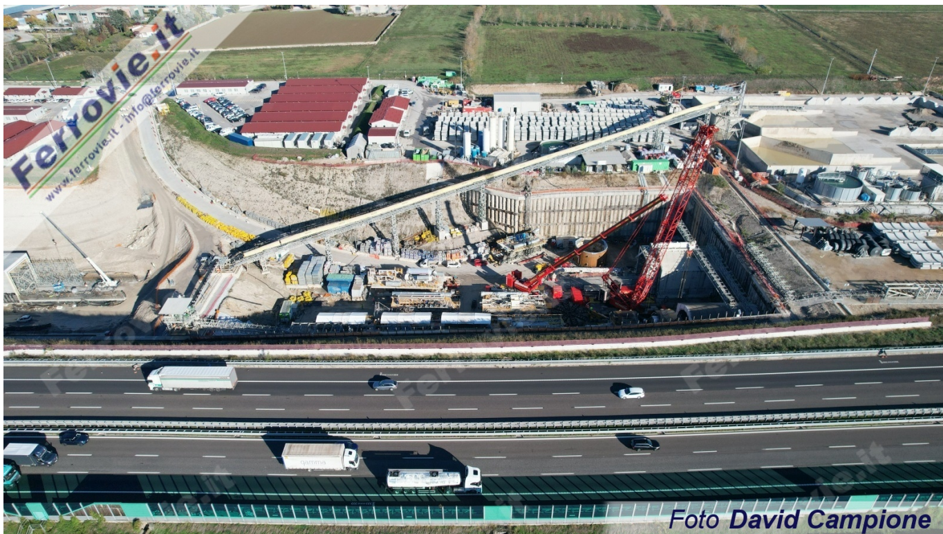
1. Il cantiere della galleria Lonato, in affiancamento all'Autostrada A4. Foto David Campione, 24 novembre 2022
