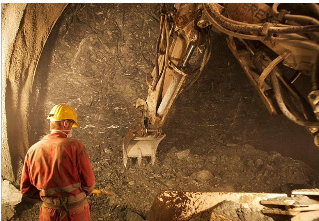
Inizio dei lavori previsto nel 2018 per la tratta di accesso Fortezza - Ponte Gardena. Foto Brenner BasisTunnel SE
