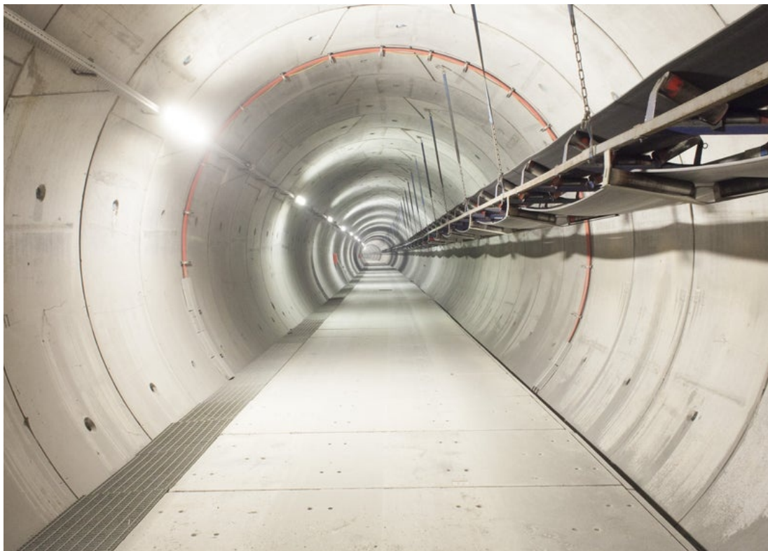
La Giunta provinciale ha approvato il progetto esecutivo della tratta di accesso sud del BBT, variante al lotto 1. Foto Nicolò Degiorgis
