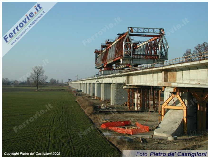
3 Lungo oltre 5 km, il viadotto Piacenza da' accesso al ponte sul Po. Qui l'opera vista lato Milano. Foto Pietro de' Castiglioni, 30 gennaio 2005
