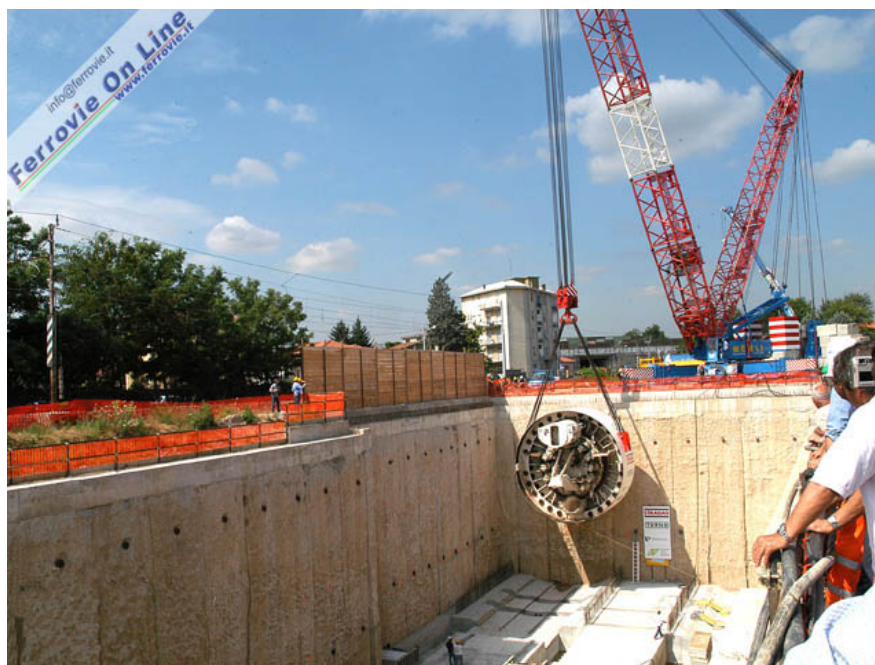
1. Il posizionamento dello scudo della fresa nel punto di inizio dei lavori di scavo. Foto Trainsphoto.it , 6 luglio 2005
