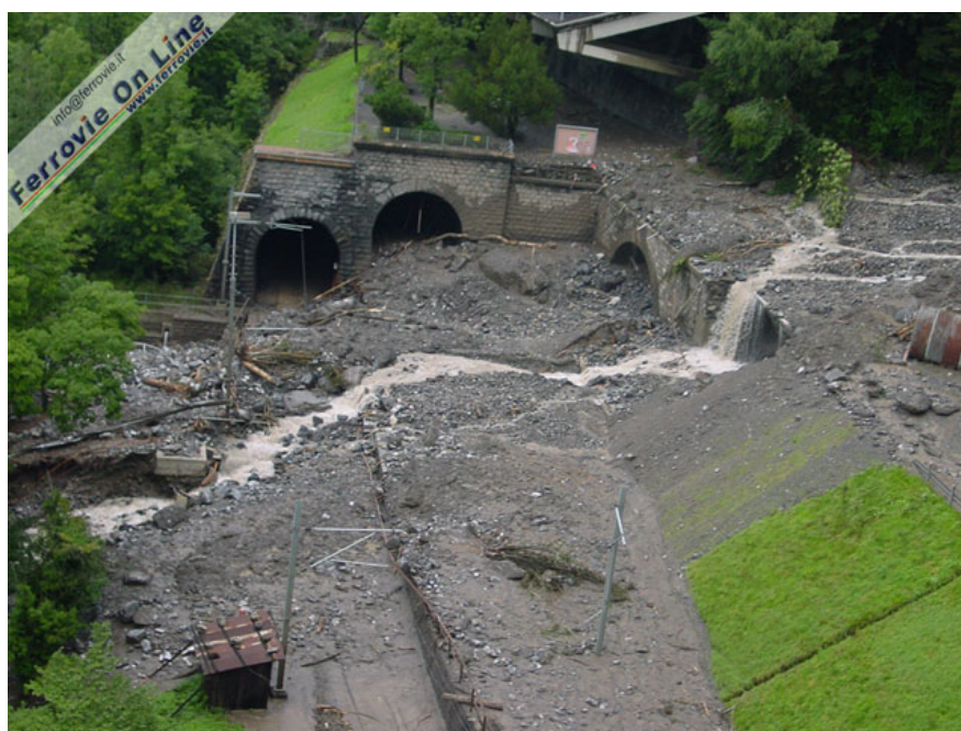
1 1 Un'immagine eloquente dei danni arrecati alle infrastrutture ferroviarie dall'ondata di maltempo che ha colpito la Svizzera. Foto SBB, 23 agosto 2005
