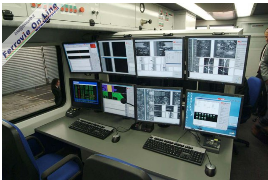
2 2 Strumentazione di bordo della Roger 1000. (Foto Mermec, 11 novembre 2005)
