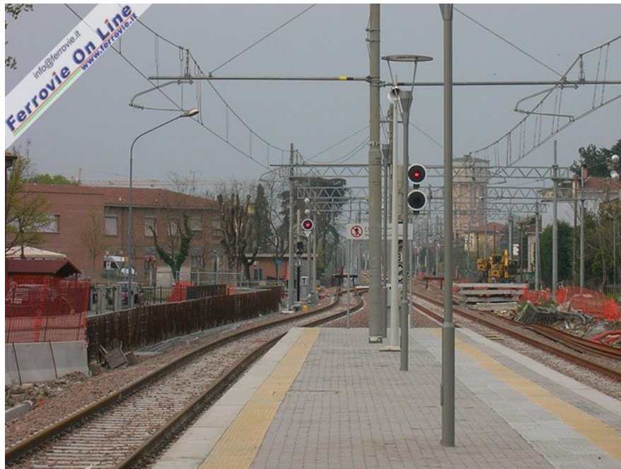
2. Vista della stazione di S. Felice sul Panaro dal nuovo marciapiede a servizio dei binari 3 e 4 in direzione Mirandola. Sulla destra dell'immagine, i lavori per il rifacimento dei binari 1 e 2. (Foto D.L., 1 aprile 2007)
