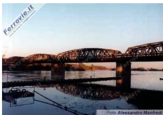
4. Il ponte in ferro sul Po nei pressi di Piacenza, con un ETR.500 in transito; il nuovo ponte strallato per la linea AV verrà costruito ad est rispetto a quello vecchio (Foto Alessandro Manfredi, 3 dicembre 1997)
