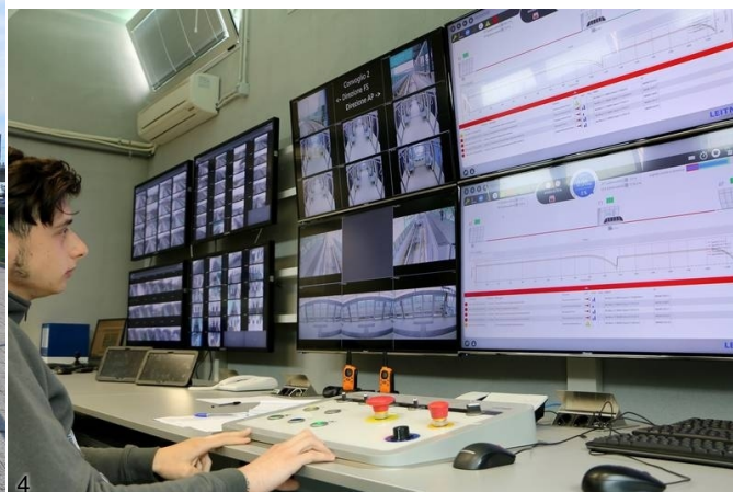
4. La sala di controllo.
