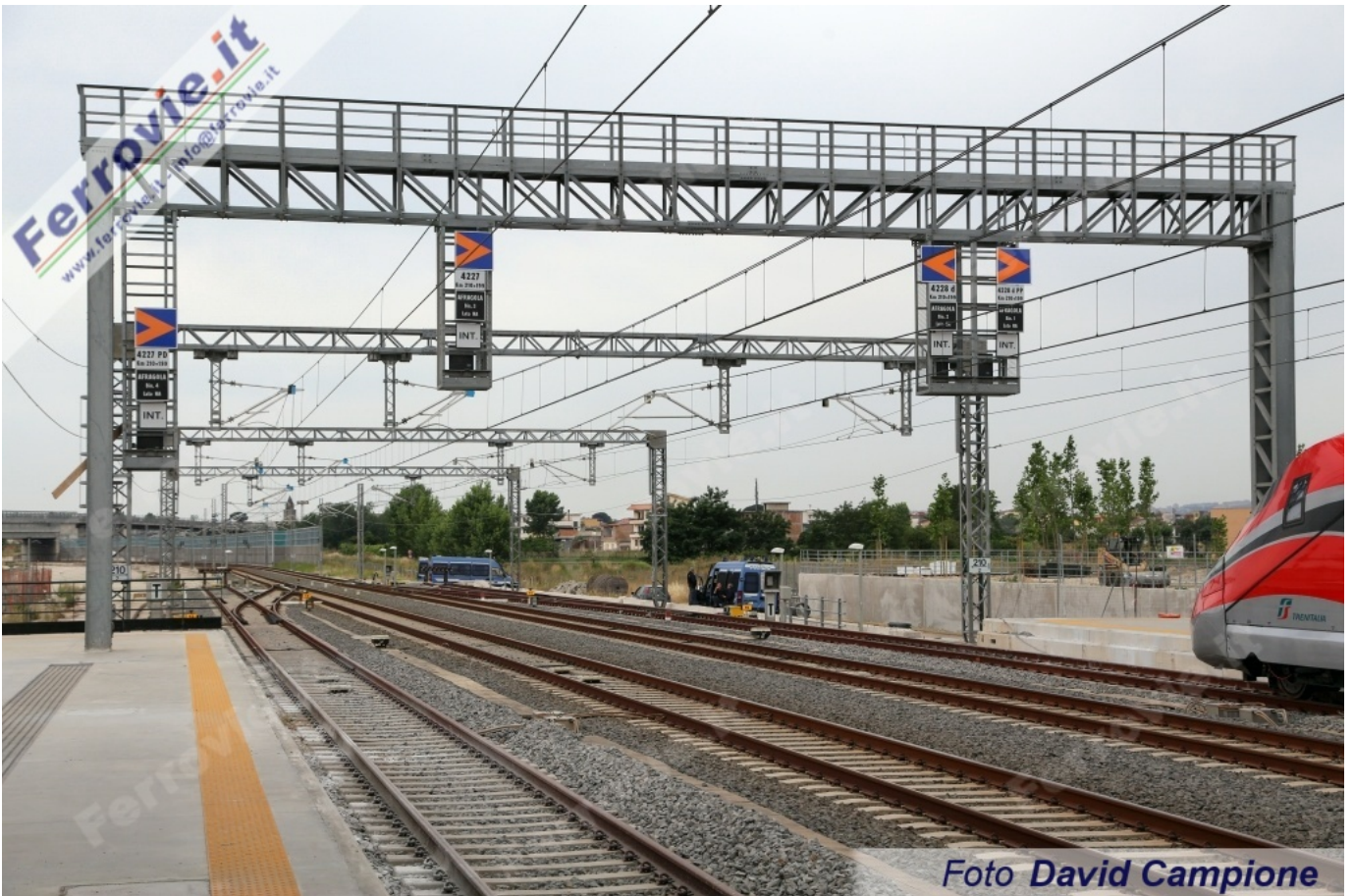
33 Portale a traliccio lato Napoli con le indicazioni di segnalamento ERTMS. (Foto David Campione, 06 giugno 2017)
