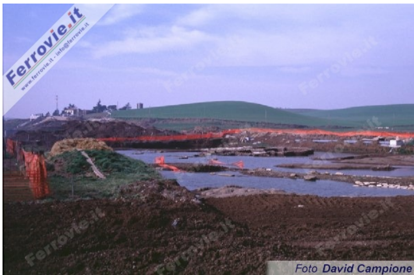
Il ritrovamento di reperti archeologici ha causato in più punti l'interruzione dei lavori. Qui siamo tra Colferro ed Anagni, dove durante i lavori di scavo sono venuti alla luce i resti di una costruzione, probabilmente un'area di ristoro per i viaggiatori che transitavano sulla vicina via Casilina. Sullo sfondo a sinistra è riconoscibile il rilevato per la sede ferroviaria, interrotto in prossimità del ritrovamento. (Foto David Campione, 2 marzo 1999)
