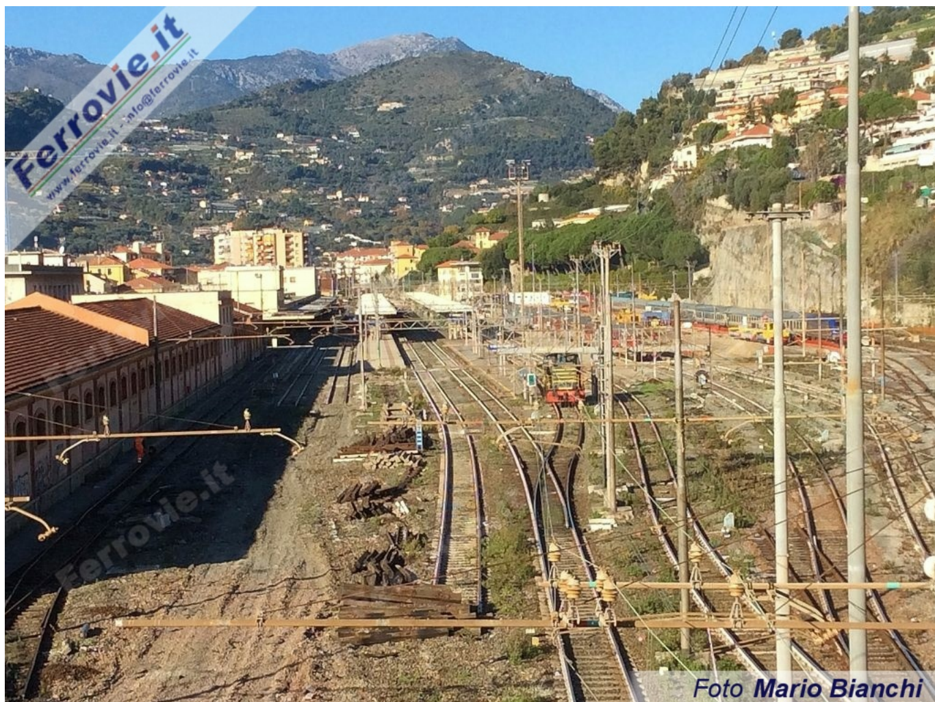
1. Veduta della Stazione di Ventimiglia con i lavori di modifica al piano di binari nelle prime fasi dell'intervento (Foto Mario Bianchi, 09 dicembre 2015)
