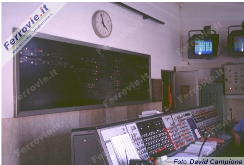
4. Banco ACEI della stazione di Roma Tuscolana. Sulla parete, in posizione frontale rispetto gli operatori, si trova il quadro luminoso, mentre sul banco è riconoscibile la pulsantiera per la costruzione dell'itinerario. (Foto David Campione, 22 giugno 1999)
