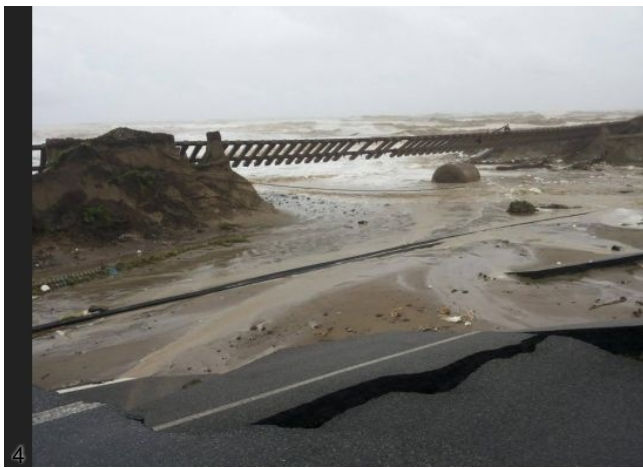
4. Ingenti i danni alla sede ferroviaria (Foto meteoweb.eu, 01 novembre 2015)
