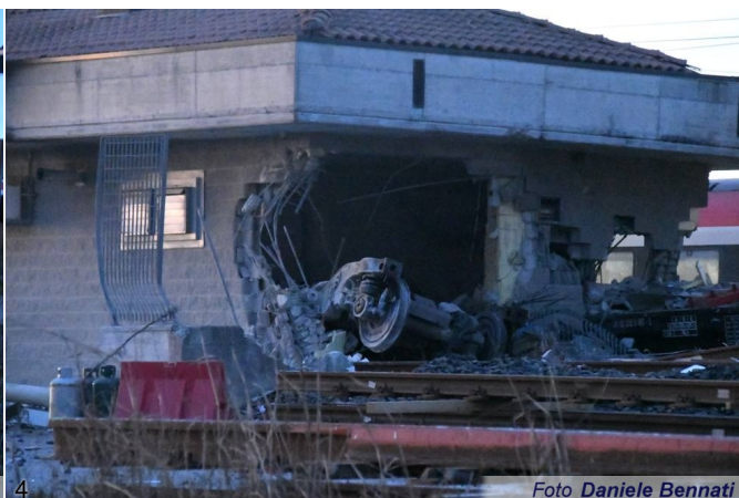
4. L'altro carrello della vettura di testa ha sfondato l'edificio del Posto di Movimento. (Foto Daniele Bennati, 06 febbraio 2020)
